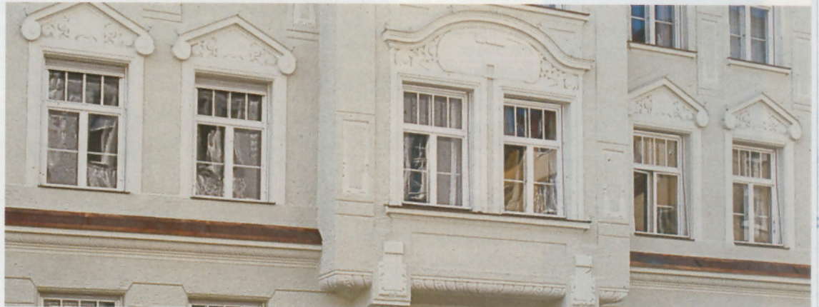
Ohmstraße 16: Die Jugendstilfassade nach der mustergültigen Renovierung (Foto oben links) Zustand der Fassade vor der Baumaßnahme: Putzschäden und die negative Farbgebung (Foto oben rechts) Vorbildlich auch die Restaurierung der Kastenfenster (Foto unten)
